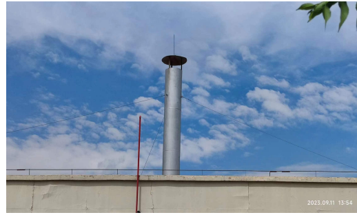
8m 高排气筒
