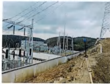
110千伏升压站出线间隔处
