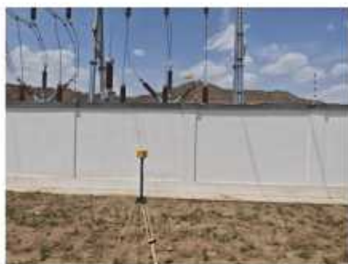
110 千伏汇兴巩昌开关站进线间隔处
