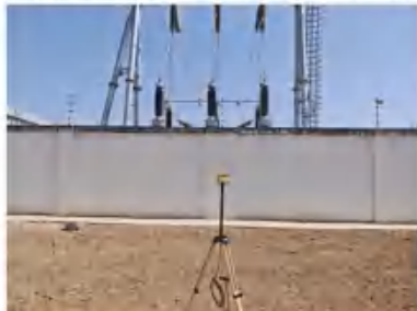
航建巩昌风电场 110 千伏升压站出线间隔处
