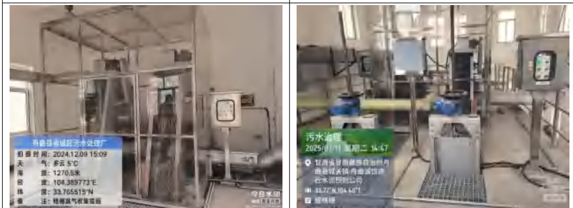
粗格栅机房臭气收集措施
