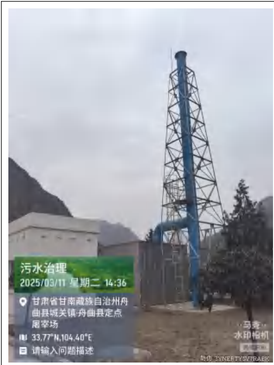
生物滤池排气筒
