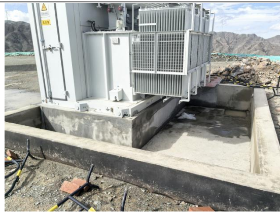
箱变事故油池
