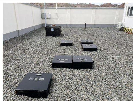
污水处理设施
