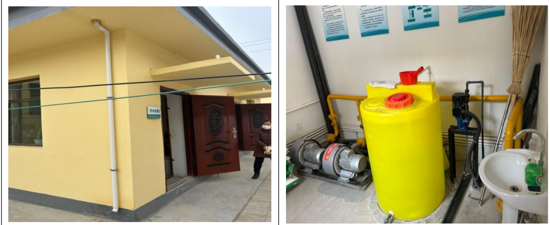
污水处理设施
